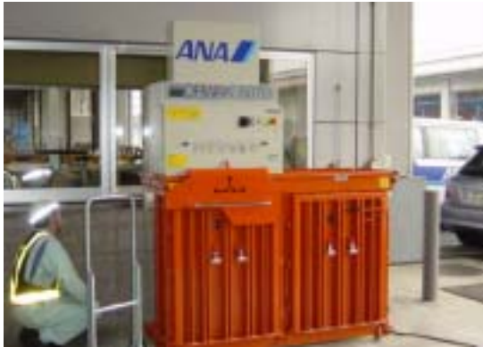
羽田空港貨物地区のごみ圧縮機
